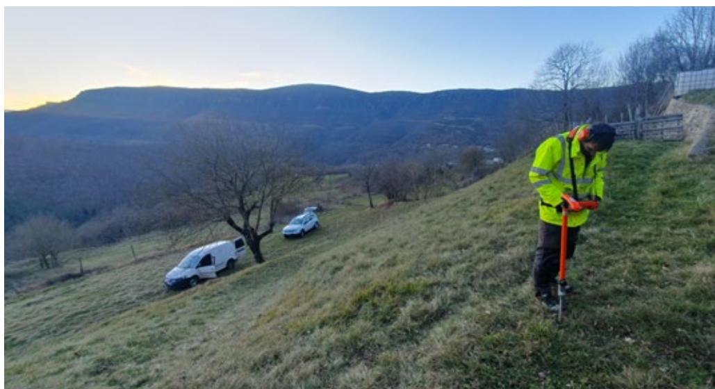
Recherche de fuite
